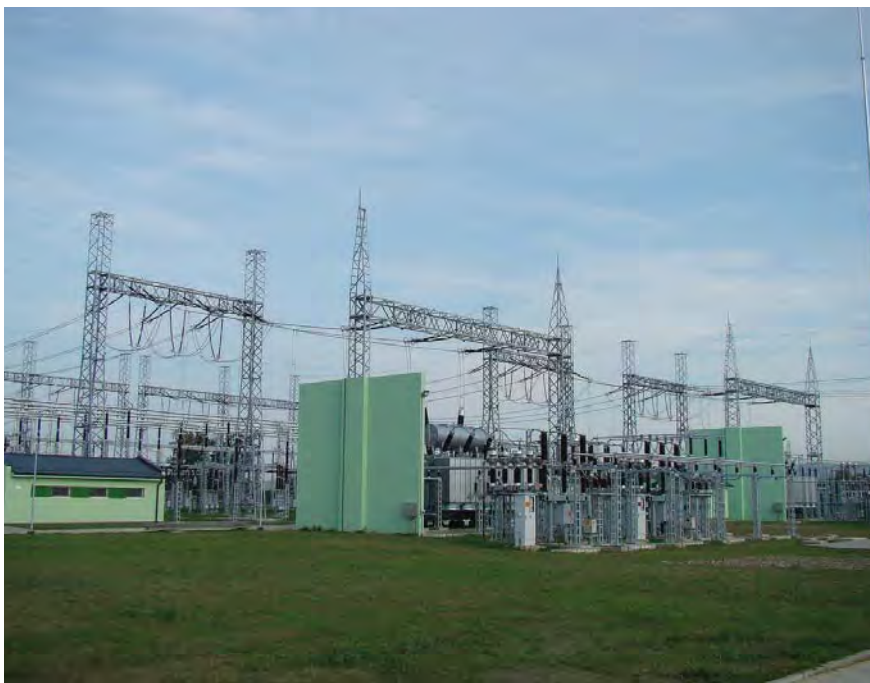
SEPS modernizuje své rozvodny – přechází na dálkové ovládání
