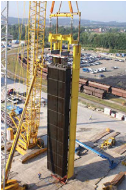
Obr. 8 – Projekt Mellach představuje naši největší zakázku v oboru spalínových kotlů a sestává ze dvou jednotek umístěných za plynovou turbínou 300 MW dodaných včetně kompletní kotelny. Každý z kotlů byl postupně sestaven z 18 tlakových svazků zavěšovaných do předmontované ocelové konstrukce
