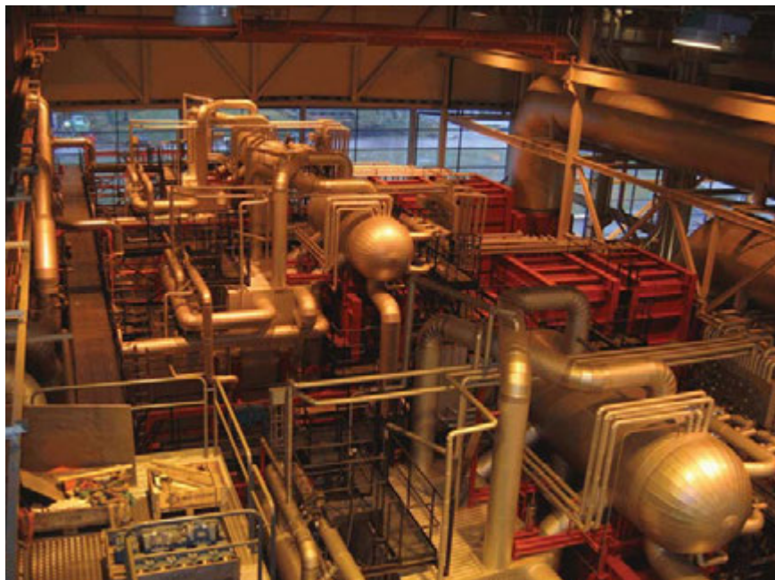
Obr. 2 – Kotelnu projektu Rya Gotteborg se třemi identickými spalinovými kotli nelze přehlédnout při vjezdu do místního přístavu. Kotle byly navrženy na teplotu 1 000 °C za hořákem a disponují chlazenou membránovou spalovací komorou
