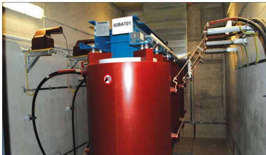
Pohled na část technologie vyvedení výkonu – ilustrační foto
