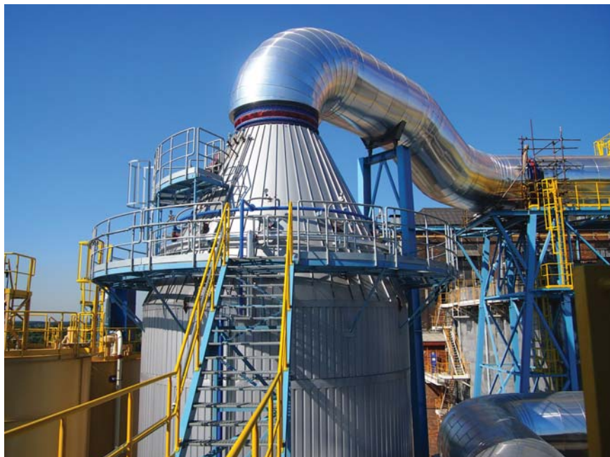
Pohled na část technologie odsíření
