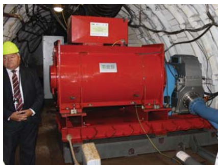
Pavel Bartoš vedle zařízení přečerpávací elektrárny
