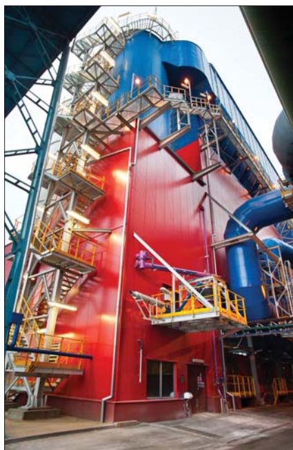
Reaktor se schodišťovou věží
