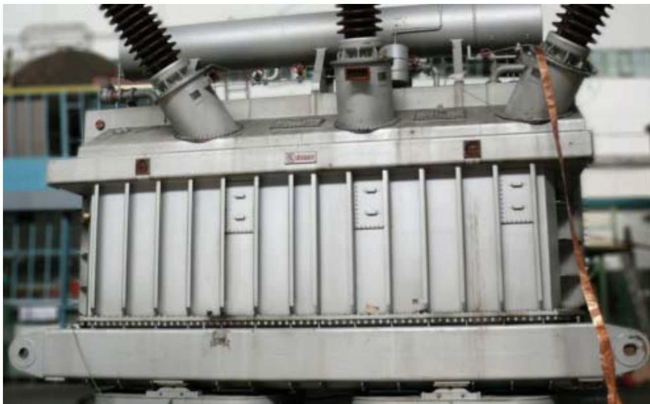
Transformátor 250 MVA před rekonstrukcí
