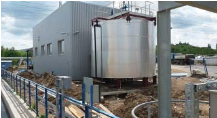
Pohled na biologickou čistírnu odpadních vod
