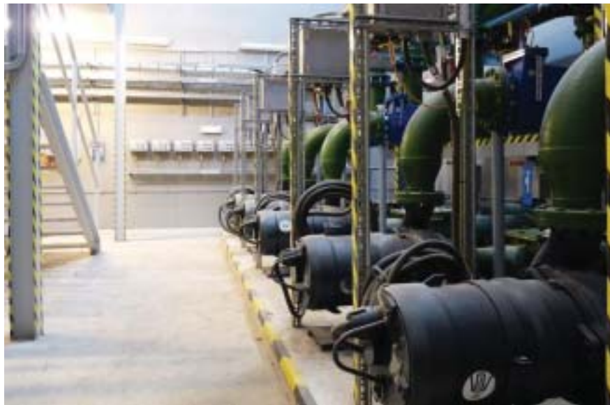
Technologická zařízení biologické čistírny
