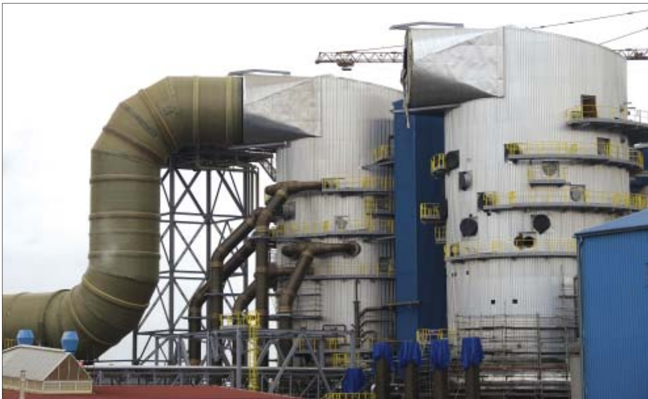
Výstup odsířeného plynu z absorberu
