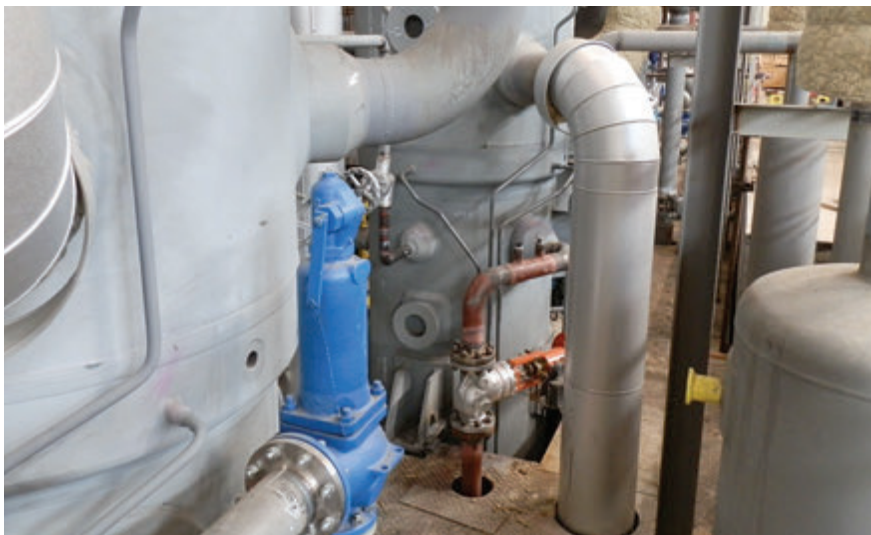
Detail usazených ohříváků v technologické lince s připojeným potrubím
