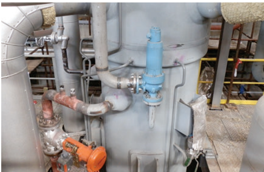
Ohřívák s připojeným potrubím, detail na pojistovací ventil
